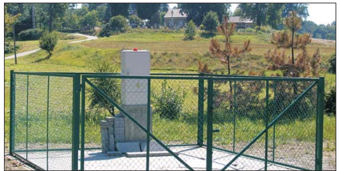
Przepompownia ścieków przy ulicy Głównej • Fot. GK
