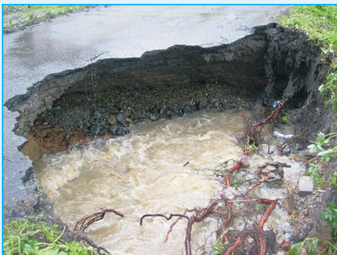
5. Zniszczony przepust pod ul. Zamkową w Kończycach Wielkich
